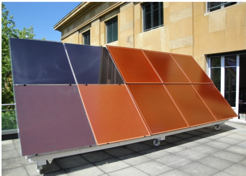
Photovoltaikmodule in Dachziegelfarben – Projekt Archinsolar mit dem PV-lab der ETH in Neuenburg. Das CSEM hat bereits eine erste Reihe von 150 Modulen umgesetzt. © CSEM 2014
