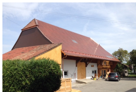
Tuiles photovoltaïques couleur terra-cotta (Projet réalisé en collaboration avec ISSOL et le CSEM, avec le soutien de l'Office Fédéral de l'Énergie, Userhuus, le Canton de Fribourg et les installateurs Solstis SA).
