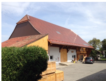
Terrakottafarbene photovoltaische Dachziegel. (Eine Zusammenarbeit zwischen ISSOL und CSEM mit der Unterstützung durch das Bundesamt für Energie sowie durch Üserhuus und den Kanton Freiburg. Installation durch Solstis SA).
