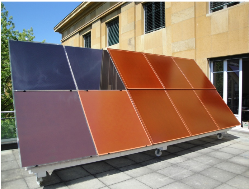
Panneaux photovoltaïques aux couleurs de tuiles – Projet Archinsolar avec le PV-lab de l'EPFL à Neuchâtel. Le CSEM a d'ores et déjà réalisé une première série de 150 modules. © CSEM 2014
